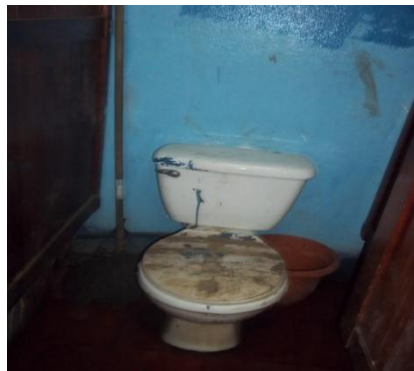
Foto 5: estado de los baños.
