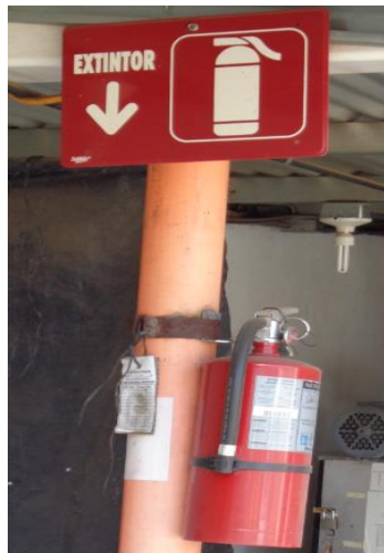
Figura N° 44. Señales de luchas contra incendios.
