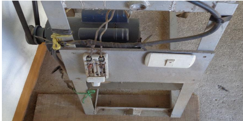
Figura N° 47. Condiciones eléctrica del Molino
