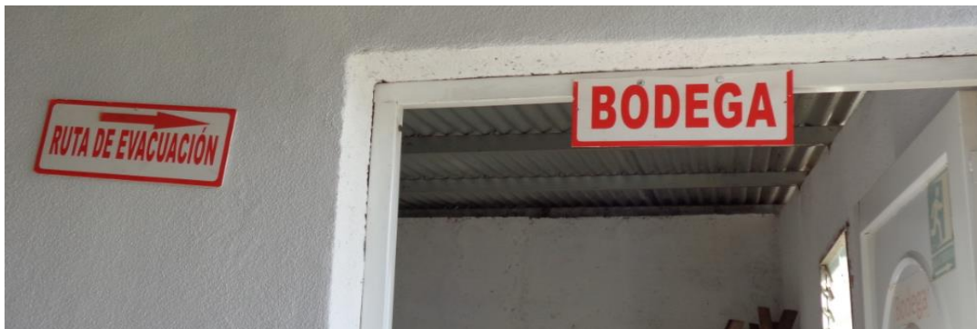
Figura N° 45. Señales de salvamento.
