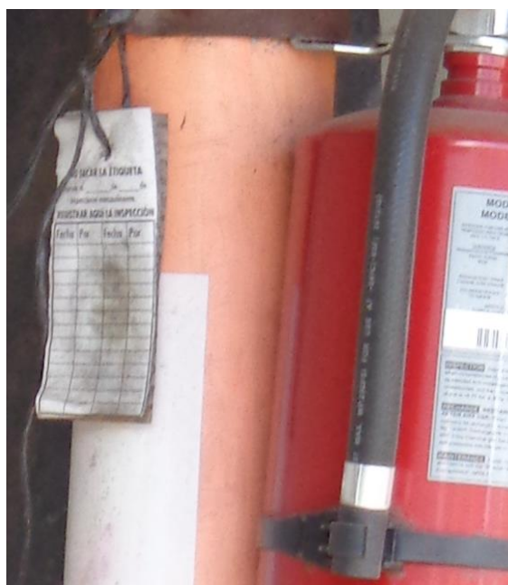
Figura N° 50. Ficha de inspección de extintor.
