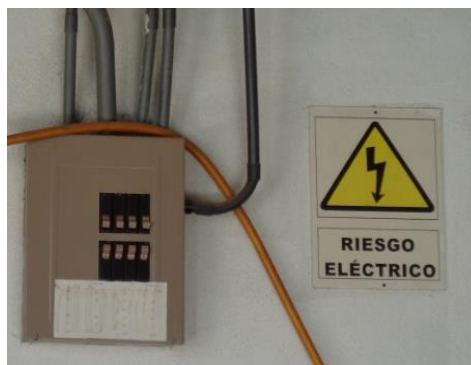
Figura N° 46. Señales de peligros.
