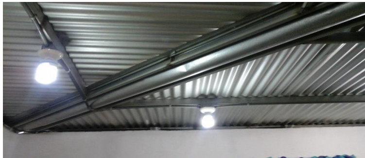
Figura N° 48. Alumbrado sin protección.
