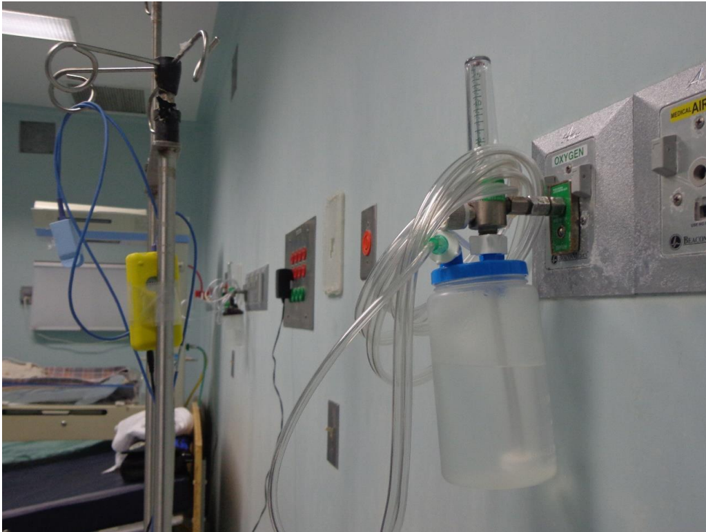
Fotografía de sistema de suministro de oxígeno Húmedo.
