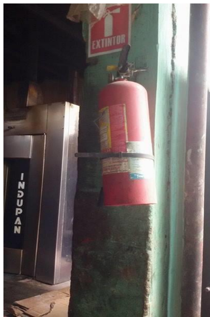
Panadería Mery Lanuza: extintor de seguridad
