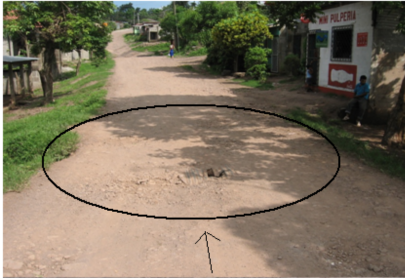
Alcantarilla en mal estado sobre la avenida 1, Dirección Norte- Sur
