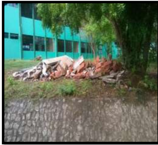
Fotos 26. Sitio que con residuos de construcción facultad de Ciencia Médica.
