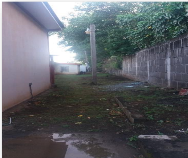
Imagen 14. Falta de canal de drenaje de agua pluvial. Fuente: Propia.
