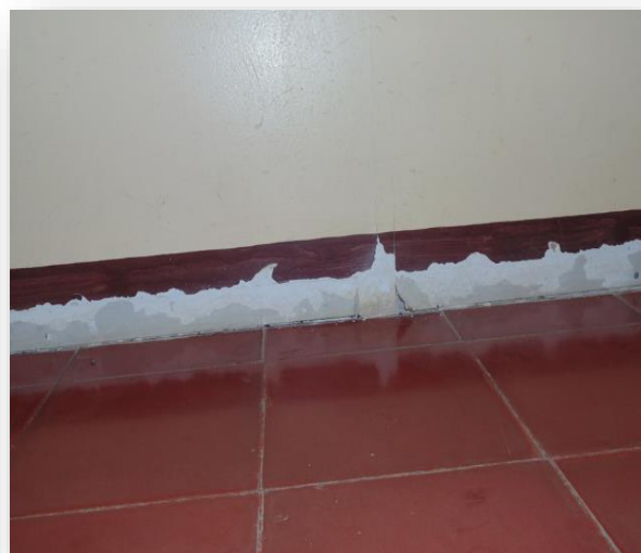
Imagen 13 Paredes sin recubrimiento en su parte inferior.
