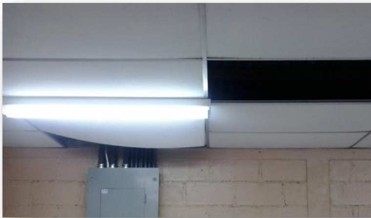
Imagen 18. Cielo falso en mal estado. Fuente: Propia.
