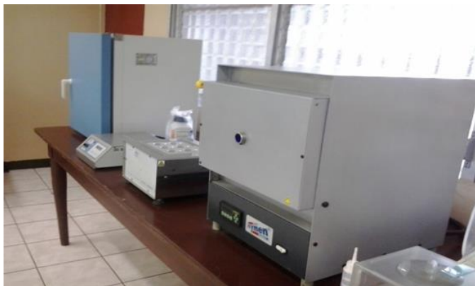
Imagen 10 Falta de voltaje 220v para utilización de hornos de secadora. Fuente: Propia.
