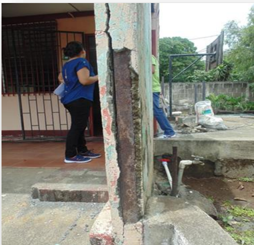
Imagen 12 Deterioro de la mayoría de paredes. Paredes expuestas a la corrosión.
