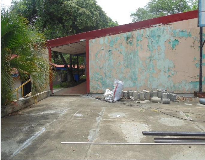
Imagen 16. Todas las paredes están faltas de pinturas y dan aspecto de abandonado. Fuente: Propia.
