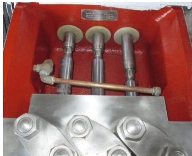
Figura 28. Tubería de agua de enfriamiento del homogeneizador. Fuente: propia
