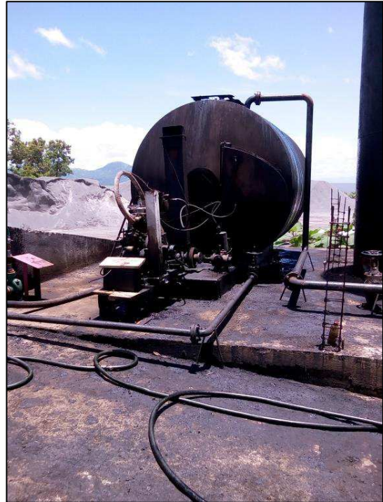
Figura 9: Caldera de planta asfáltica.
