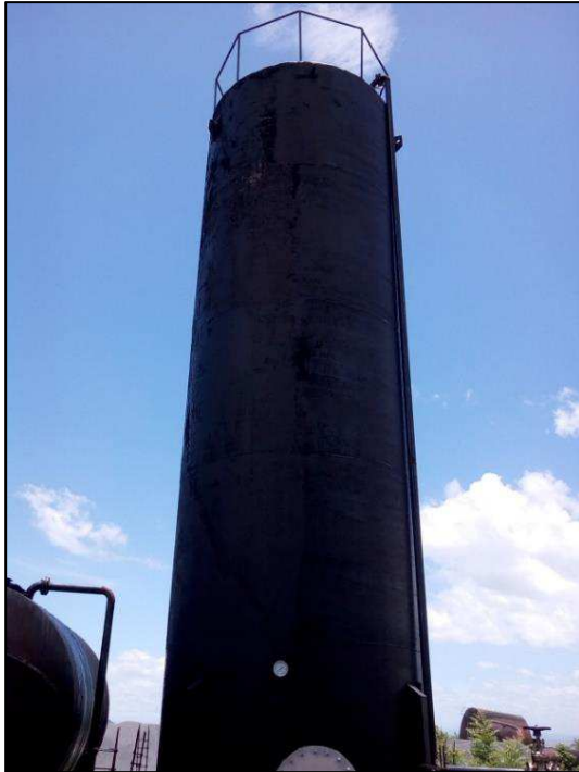
Figura 8: Tanque de emulsión (15,000 gls).
