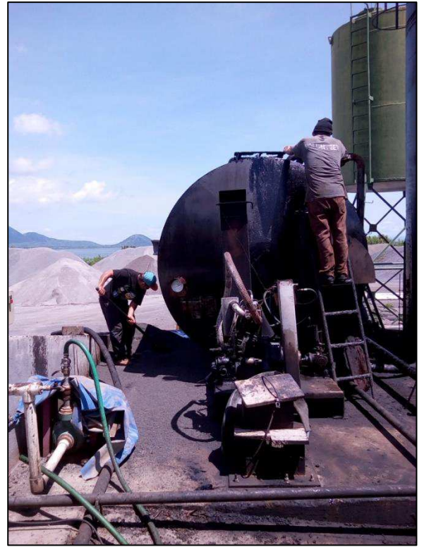
Figura 21: Limpieza de caldera.
