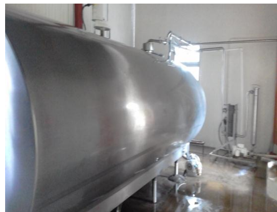
Figura 7. Tanque de almacenamiento
