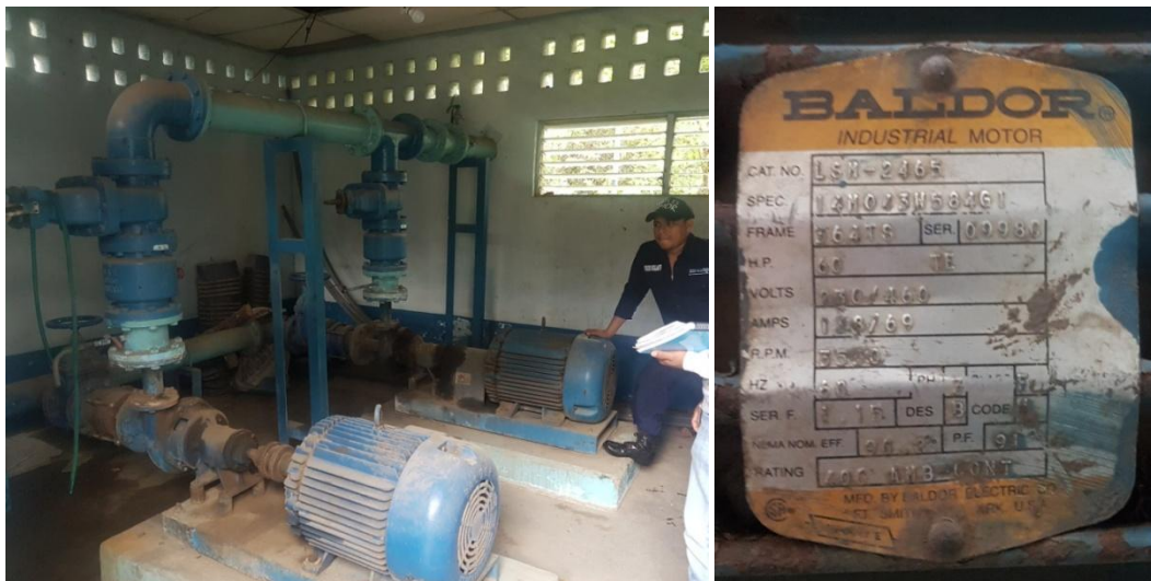
Fotografía 7: Equipos de Bombeo existentes en P2 (60Hp).
