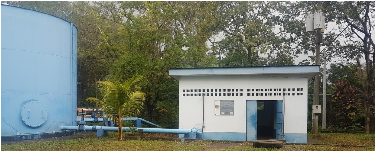
Fotografía6: Caseta en estación de rebombeo P2
