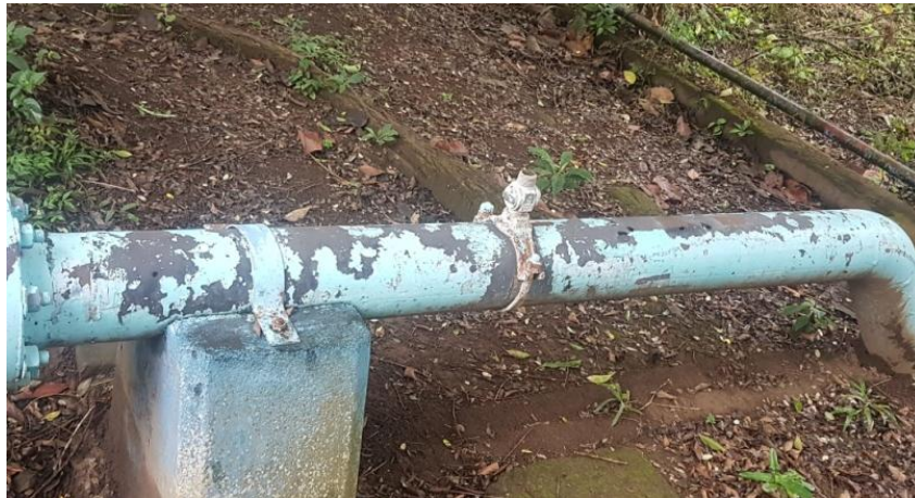
Fotografía 2, Línea de Conducción de 8 pulgadas en P1. Fuente. Fotografía tomada por H. Ramírez
