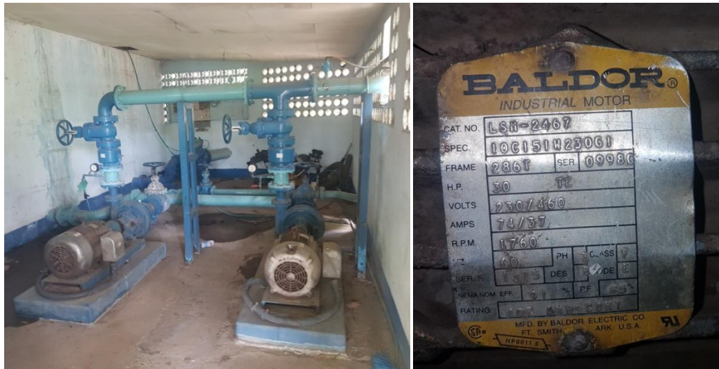
Fotografía 8: Equipos de Bombeo Tanque de 200,000 Glns (30Hp)
