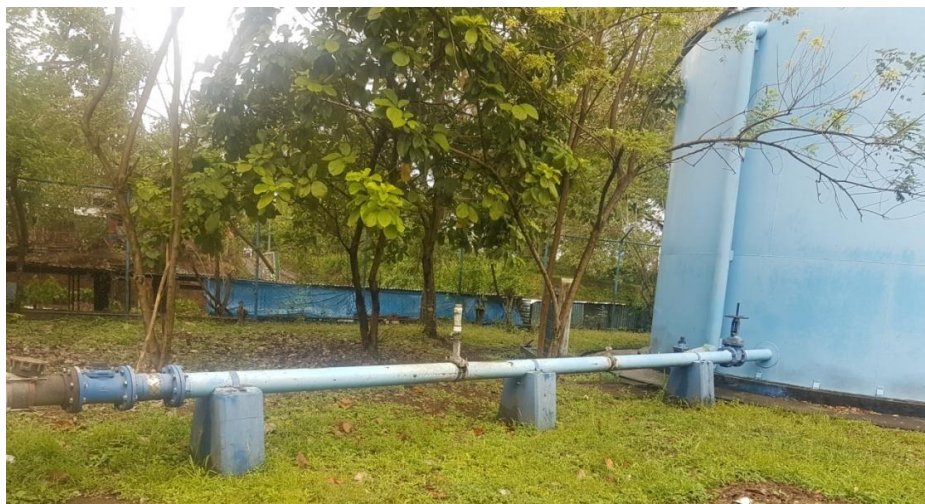
Fotografía 1. Línea de Conducción de 8 pulgadas en P2 conectada al tanque de 50,000 Galones.
