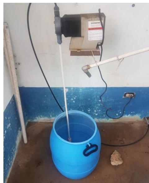
Fotografía. Sistema de Cloración, con tubo flexible de succión Ø3/8" LV/PL P/Cloración Fuente. Fotografía tomada por H. Ramírez
