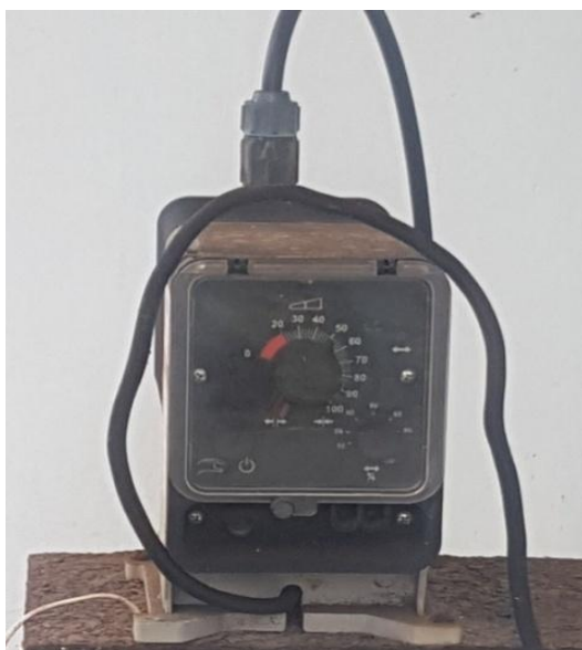
Fotografía 5. Dosificadora de cloro, Siemens, 5 GPD, 100 PSI. En buen uso. Fuente. Fotografía tomada por H. Ramírez.
