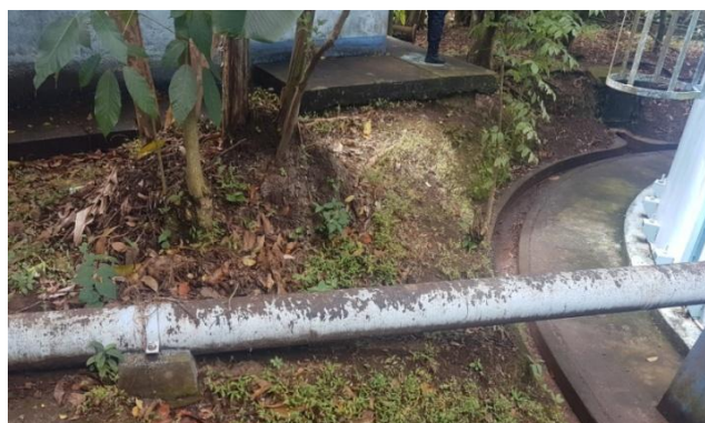
Fotografía 4, Línea de Conducción de 8 pulgadas conectada en tanque de 200,000 Galones. Fuente. Fotografía tomada por H. Ramírez
