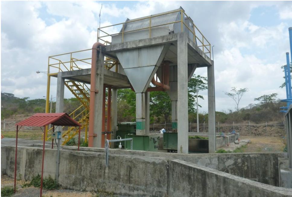
Imagen 1 TRATAMIENTO PRIMARIO (Cribado) PTAR (BOACO)
