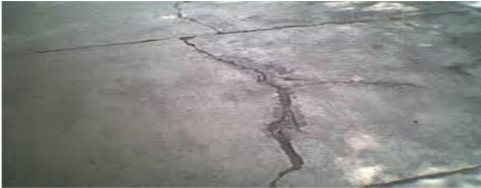
Figura 1. Deterioros en el piso, debido al peso y paso de medios de transporte.
