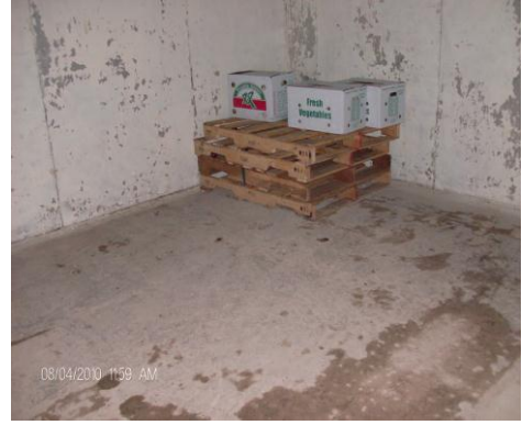
Ingreso al cuarto frio
