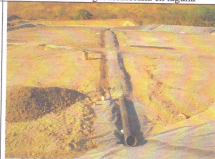
Tubería de HDPE perforada y recubierta con grava para recolección de lixiviados
