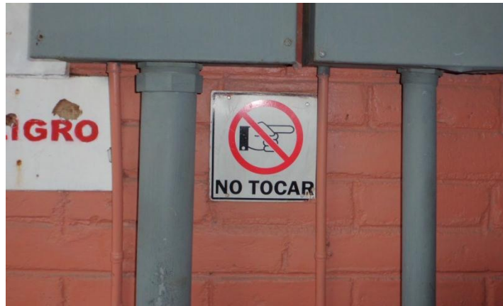
Señalización de no tocar: En esta área hay paneles de alto voltaje.
