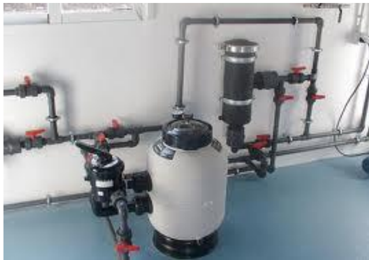
Figura 3. Filtro de arena sílice
