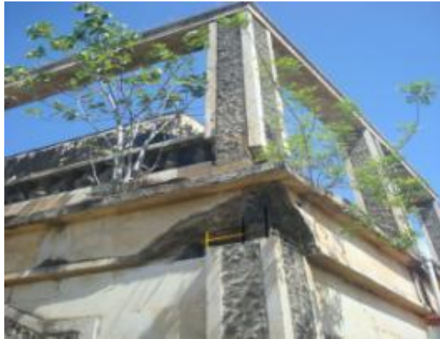
Figura 43 Columna de primer nivel que fue aplicada sin agregar refuerzo
