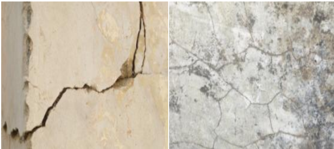
Figura 4 Grietas y fisuras en elementos estructurales
