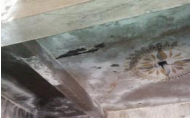
Figura 39 Descascaramientos en losa de entrepiso
