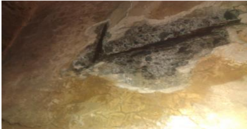
Figura 28 Ensayo con fenolftaleína en muro.
