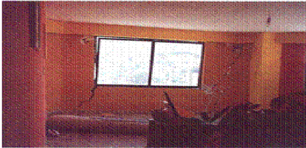
Figura 11 Fisuras en columnas y paredes interiores producidas por los asentamientos de una de sus columnas.
