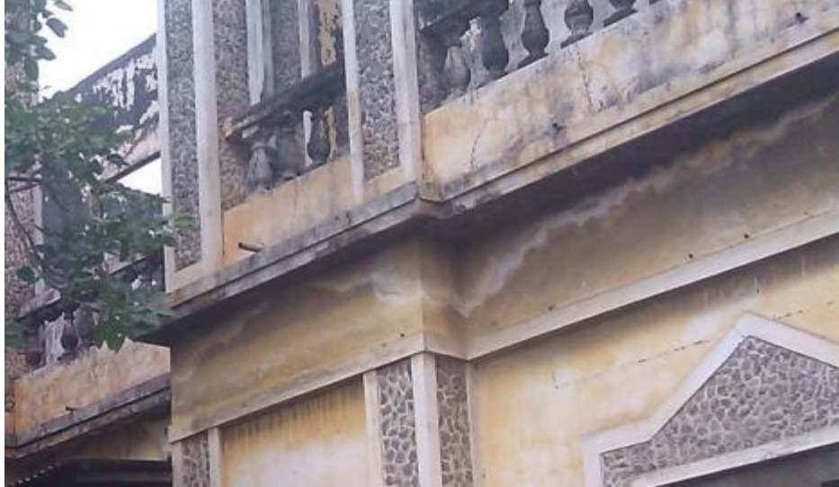
Figura 6 Eflorescencia en viga de entrepiso Antigua Nunciatura Apostólica.
