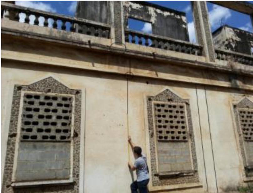
Figura 41 falta de alineamiento
