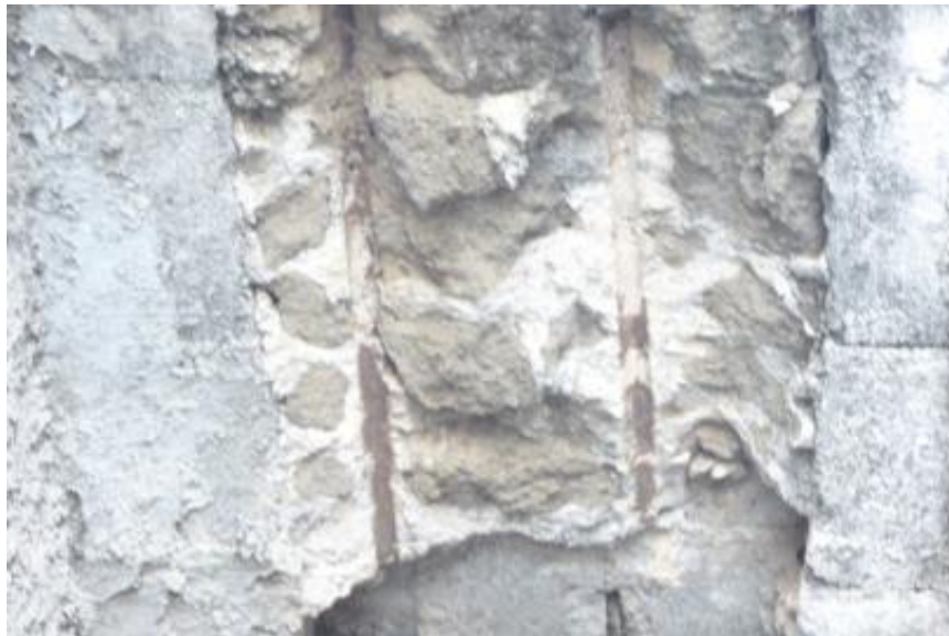
Figura 22 Desprendimiento del acero de refuerzo y de concreto
