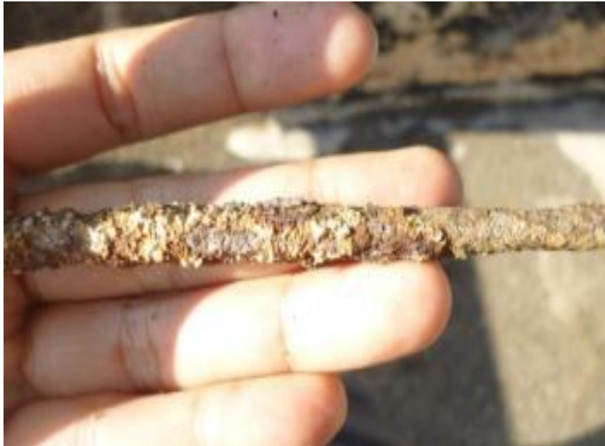
Figura 7 Proceso avanzado de corrosión en el acero de la estructura.
