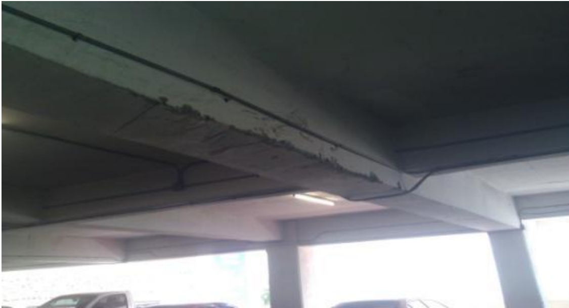
Figura 5. Mecánicas causadas por el hombre en la estructura.
