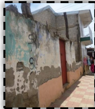
Imagen 18. Afectación de fachadas
