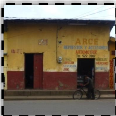
Imagen 19. Afectación de fachadas
