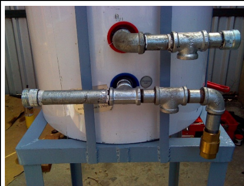
Fig. No.2 Conexiones entre tanque y colector
