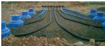
Foto: Tuberías UPP
