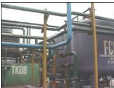
Foto: Tubería AMERON usadas en la Refinería
