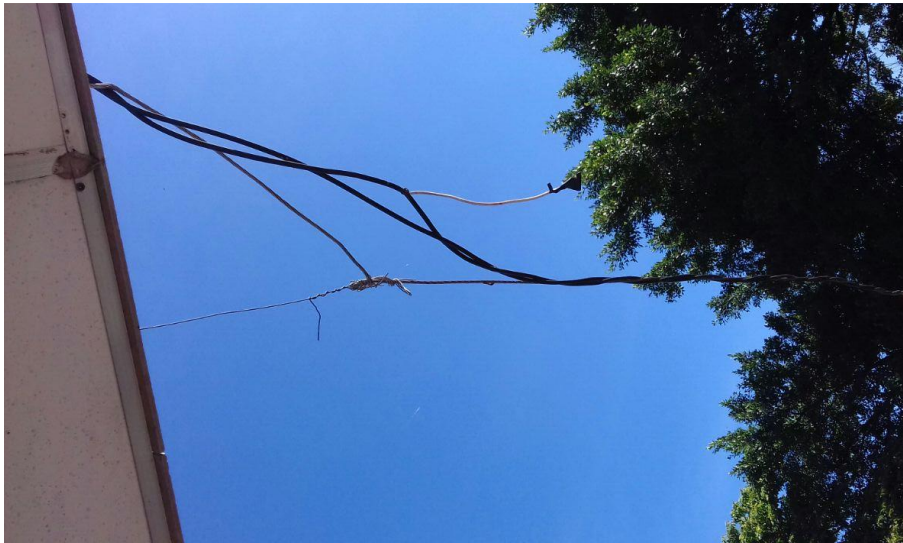
Foto 6. Malas instalaciones en el servicio eléctrico
