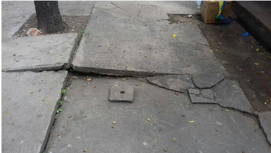
Foto: Mal estado del embaldosado. Tomada por: Alba Tercero Cruz.
