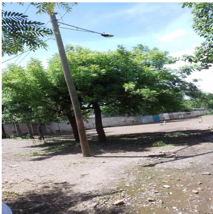
Foto: Tendidos eléctricos y árboles en la zona de seguridad. Tomada por: Norberto Mendoza A.
