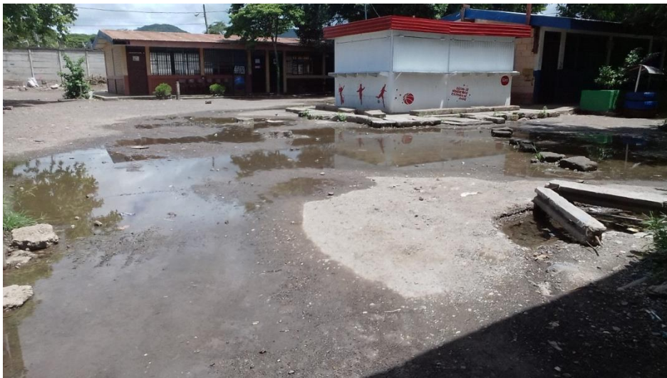
Foto: Tuberías rotas. Tomada por: Norberto Mendoza Artola.
