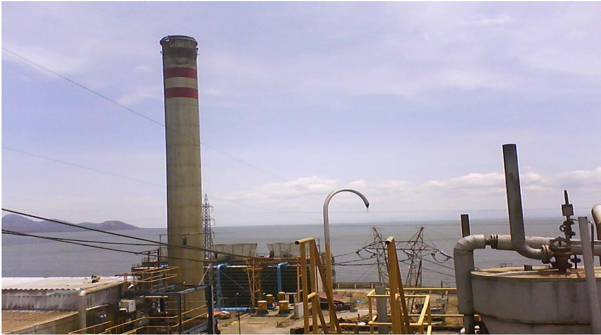
Figura 20. Chimenea de la U-3.
