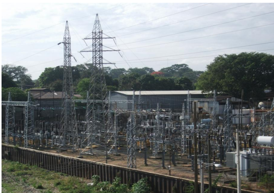
Figura 19. Subestación de Planta Managua
