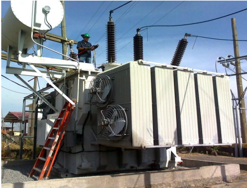
Figura 15. Transformador Principal 53,000 KVA Fuente: Bendaña, N., Briceño A. & Sánchez Y. (2012).
