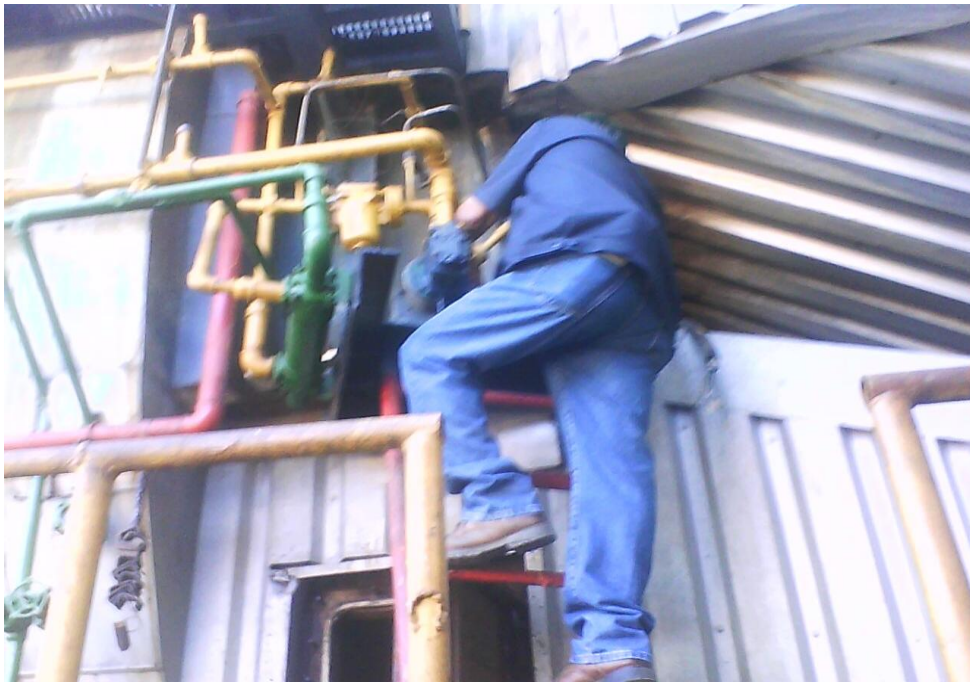
Figura 17. Exterior de la caldera
