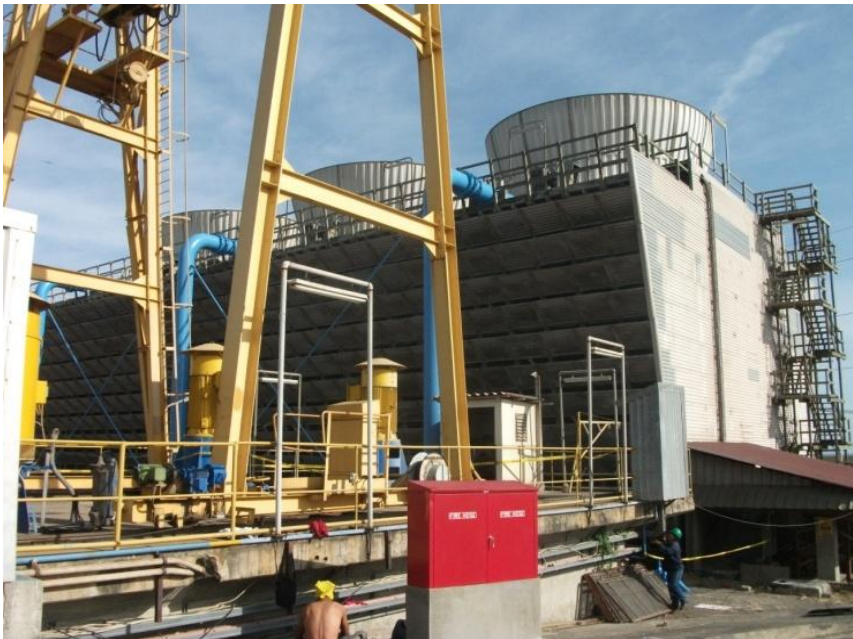
Figura 16. Torre de enfriamiento Fuente: Bendaña, N., Briceño A. & Sánchez Y. (2012).
