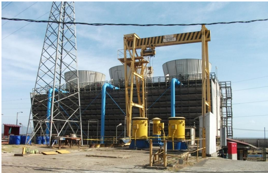
Figura 18. Torre de enfriamiento U-3
