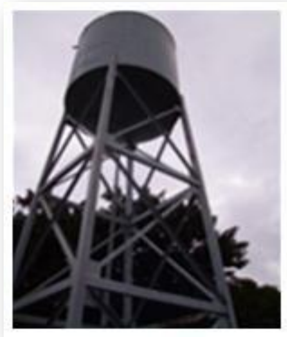
Ilustración 17: Tanque sobre torre, capacidad de 9000 galones, Momotombo.
