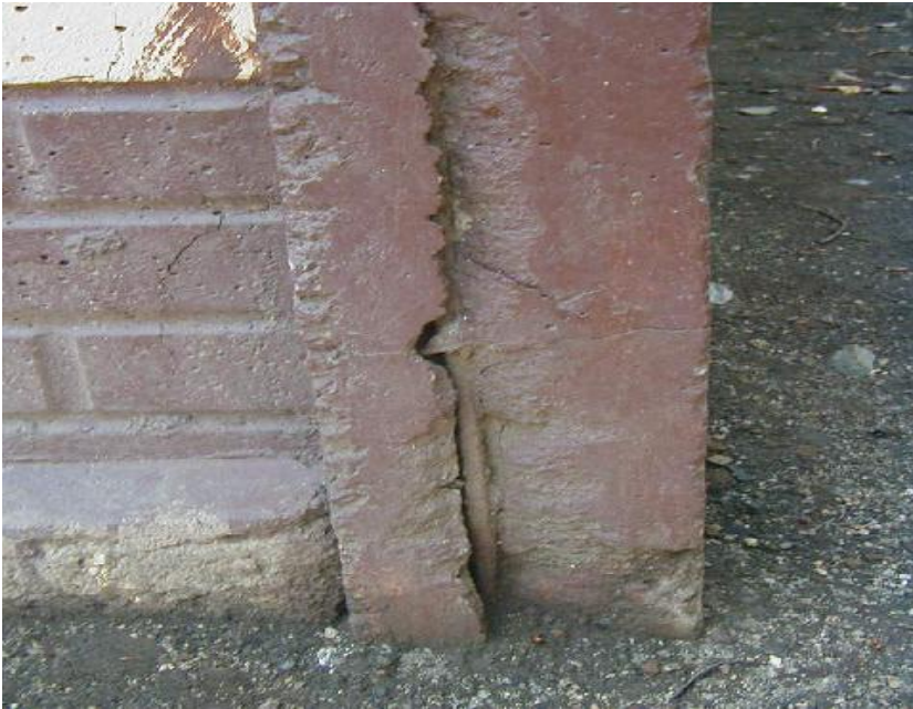
Foto 6: Columna con fracturas y desplome
