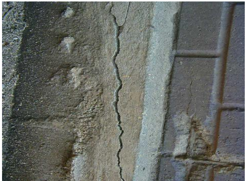
Foto 6: Columna con fracturas
