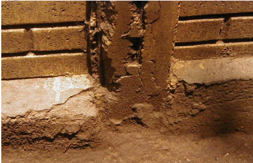
Foto 5: Columna con fracturas y elementos expuestos
