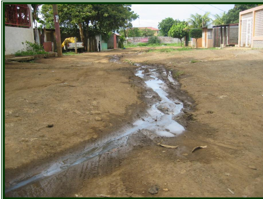
Las aguas residuales deterioran las vías internas del barrio por la ausencia de una infraestructura sanitaria.
