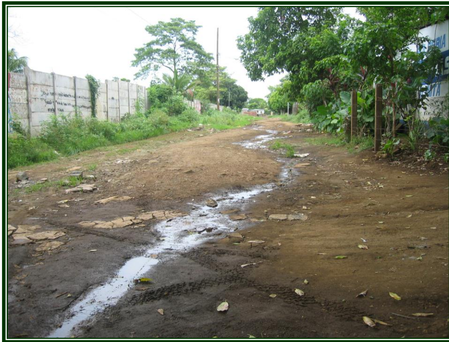
Figura 3. Evacuación de las aguas residuales por las vías internas del Barrio Reparto España.
