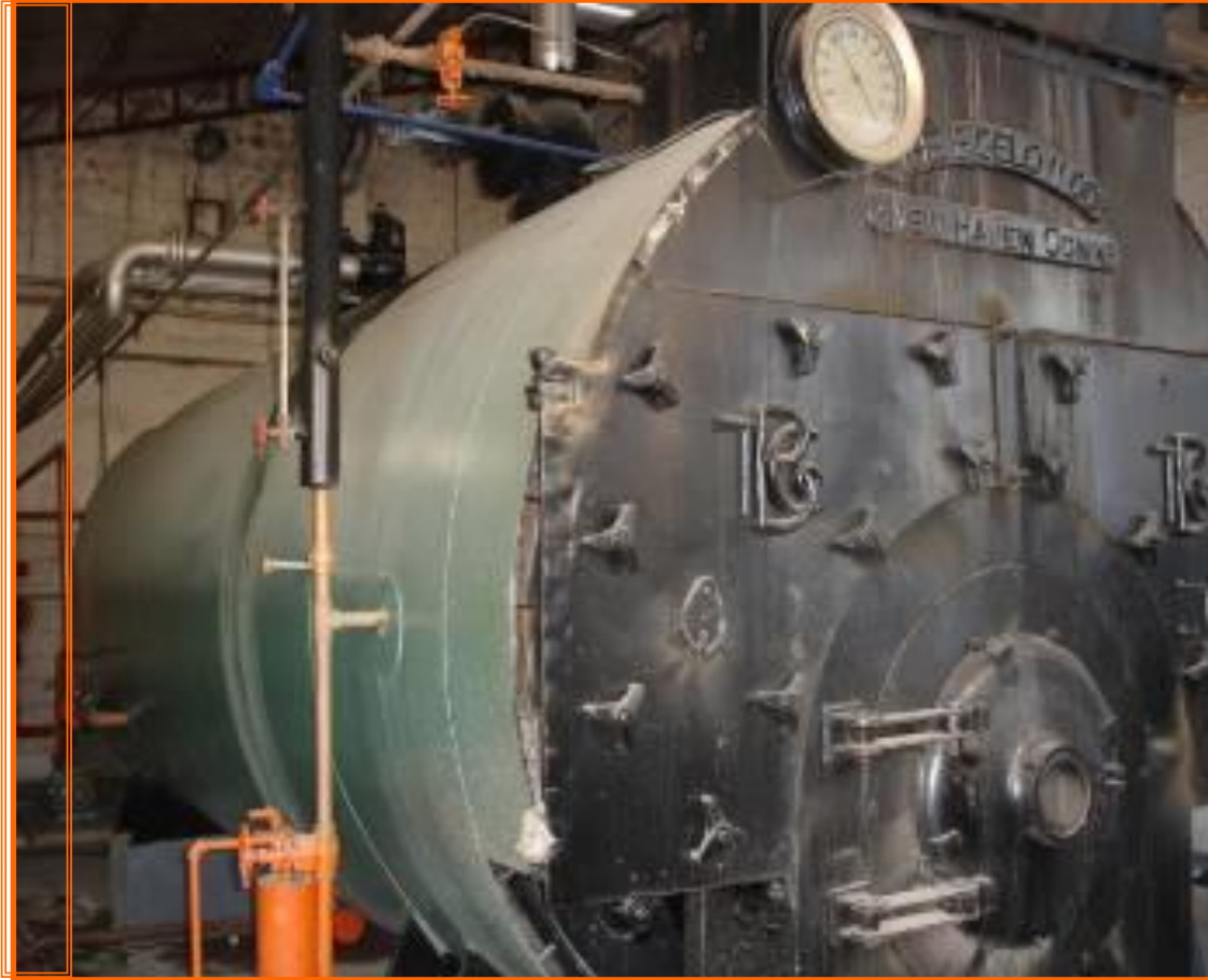
Figura N° 6: Caldero de vapor tipo biomasa:
