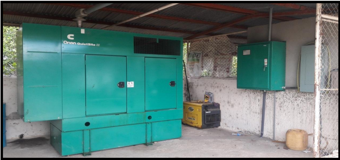
Figura N°13.SISTEMA DE GENERADOR UPS.
