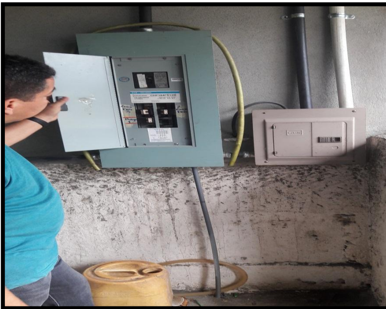
Figura N°15. CONTROLADOR BREAKER DEL SISTEMA ELÉCTRICO.
