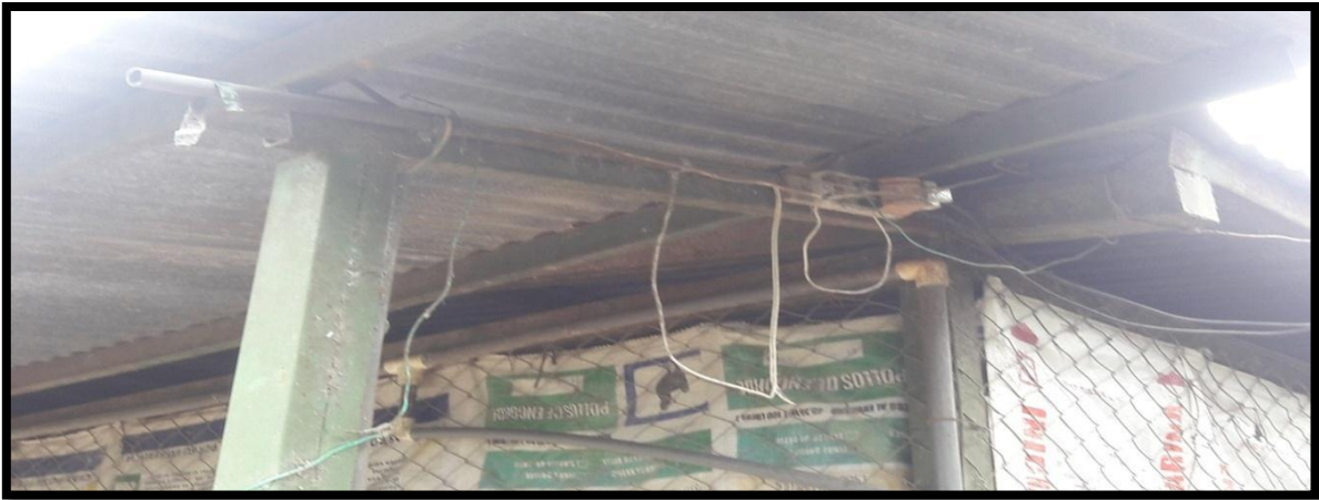
FIGURA N°17. SISTEMA ELÉCTRICO EN ESTADO DESFASADO EN EL ÁREA DE GALPONES.
