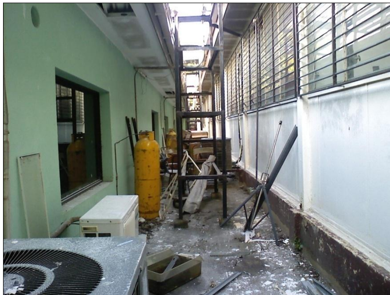
FOTO 7: Los tanques de gas butano se encuentran ubicados en un área inapropiada y sin ninguna protección.
