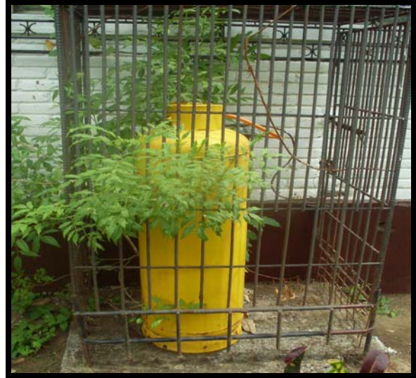
Fig. nº 2. Se observa que los tanques de gas butano están ubicados fuera de las instalaciones en un sitio de poca circulación.
