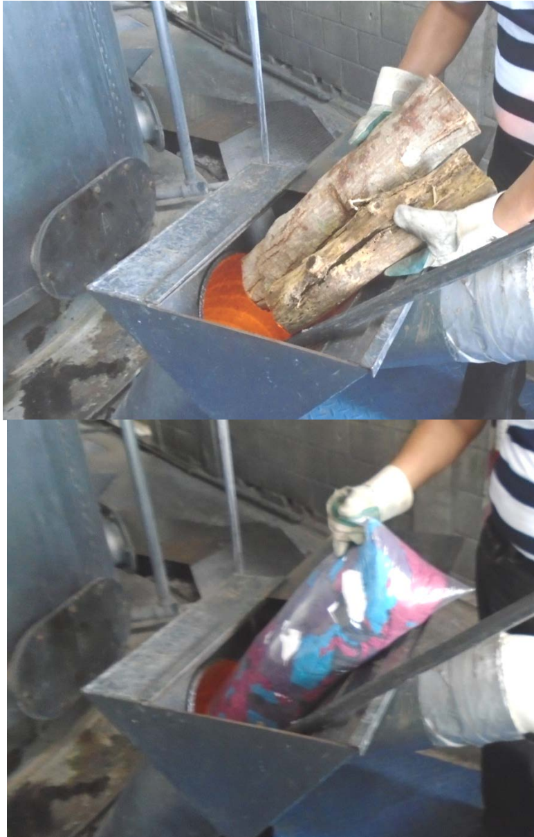
Ilustración 5 Alimentación de Caldera de Biomasa
