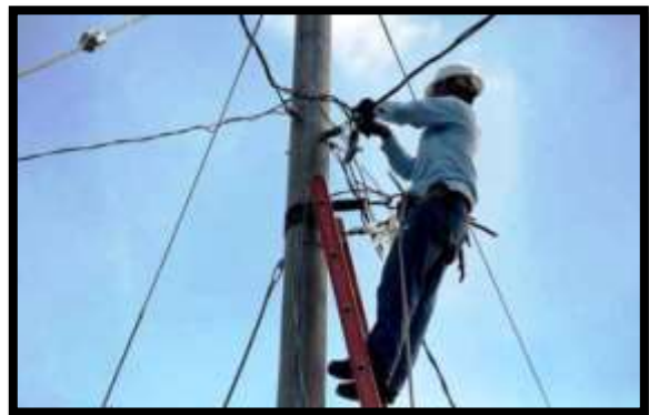
Asistencia de ENATREL para la calidad en el tendido eléctrico Foto: Fuente secundaria extraída de la página web
