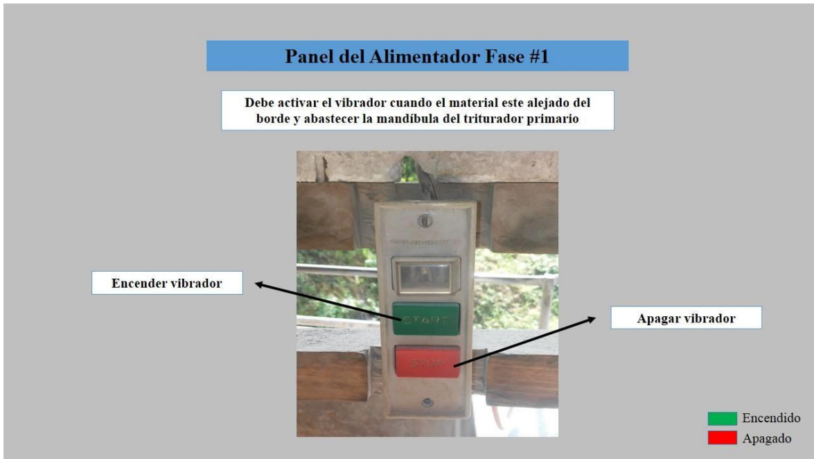
Ilustración 5: Panel del alimentador Fase 1
