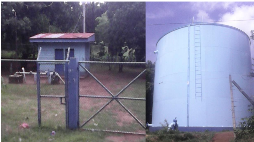
Imagen 2. Pozo y Tanque de almacenamiento de agua potable.
