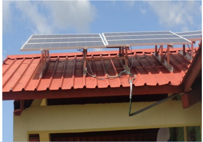
Paneles solares en el techo del centro de información (foto tomada en visita de campo)
