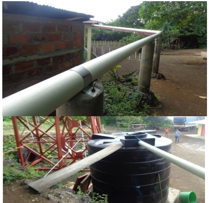
Agua recogida y tratada de lluvia para uso del centro (foto tomada en visita de campo)
