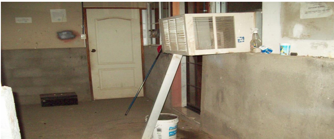
Figura 46. Soporte y sistema de drenaje inadecuado en aire acondicionado.
