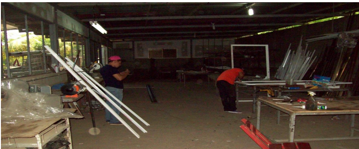
Figura 47. Colaboradores sin equipos de protección personal.
