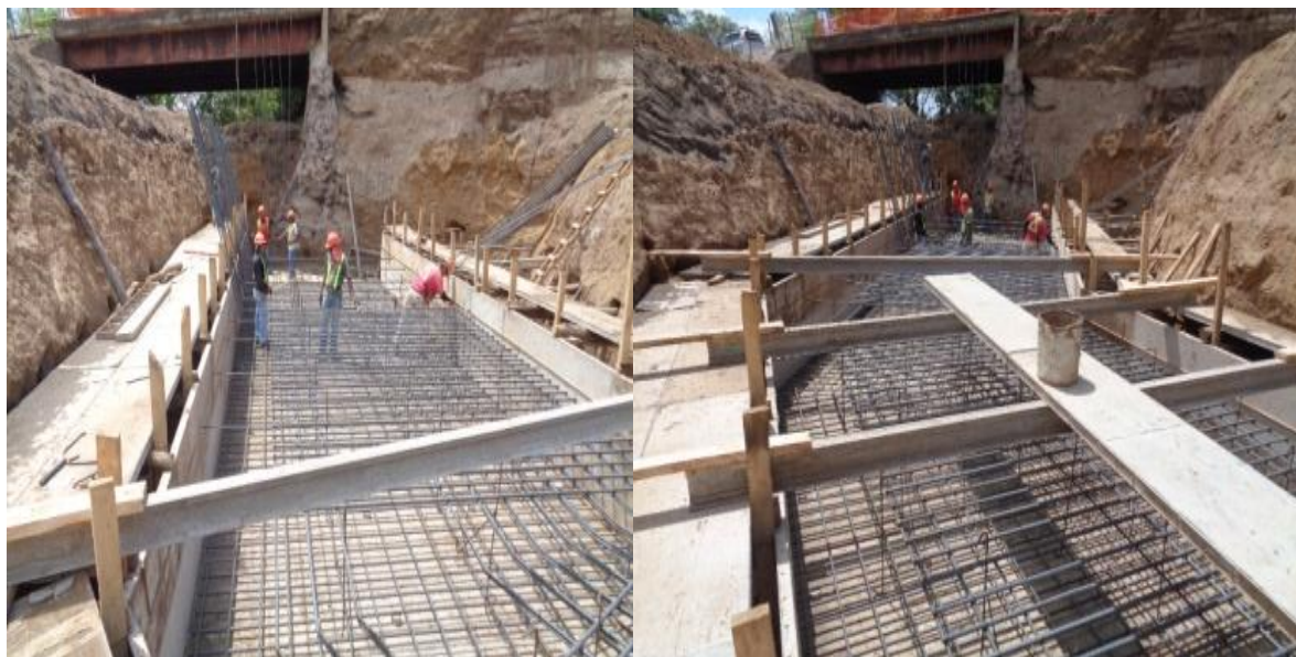
Foto#4Colocación y armado acero de refuerzo en zapatas, aguas arriba-Puente Momotombo- Carretera La Paz Centro – Malpaisillo. Fuente: Edicro S.A.
