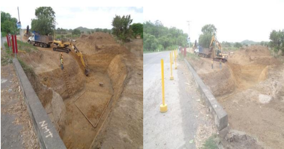
Foto#1-Excavación para estructura, estribo N°1, aguas arriba, Puente Momotombo- Carretera La Paz Centro – Malpaisillo. Fuente: Edicro S.A.
