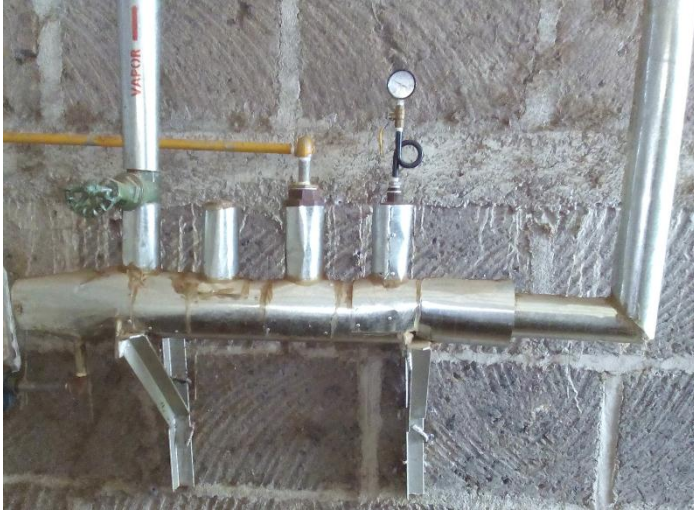
Ilustración 11: Tuberías de distribución general de vapor con soportes.
