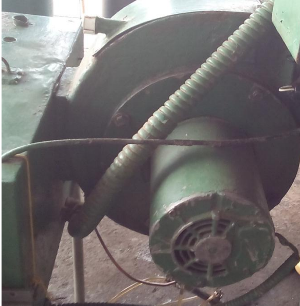
Ilustración 7: Motor del ventilador de la caldera.
