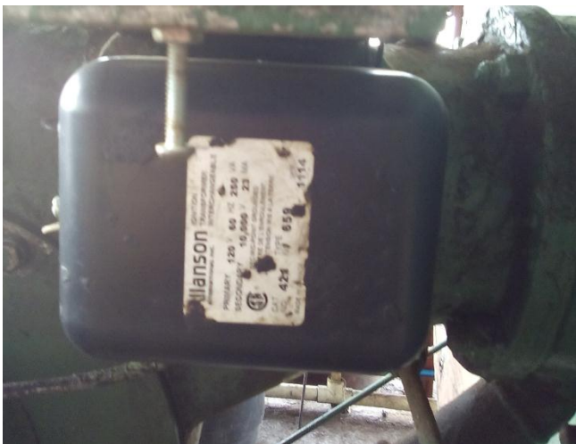
Ilustración 9: Transformador de ignición de la caldera.
