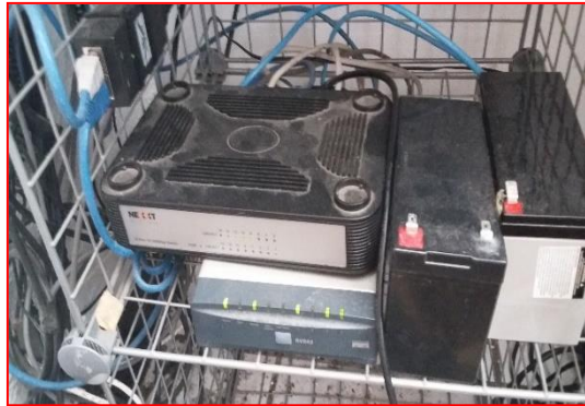
Router y switch
