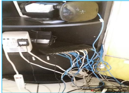
Punto de acceso y switch
