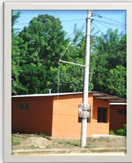
Foto 22: Poste de distribución eléctrica Fuente Propia
