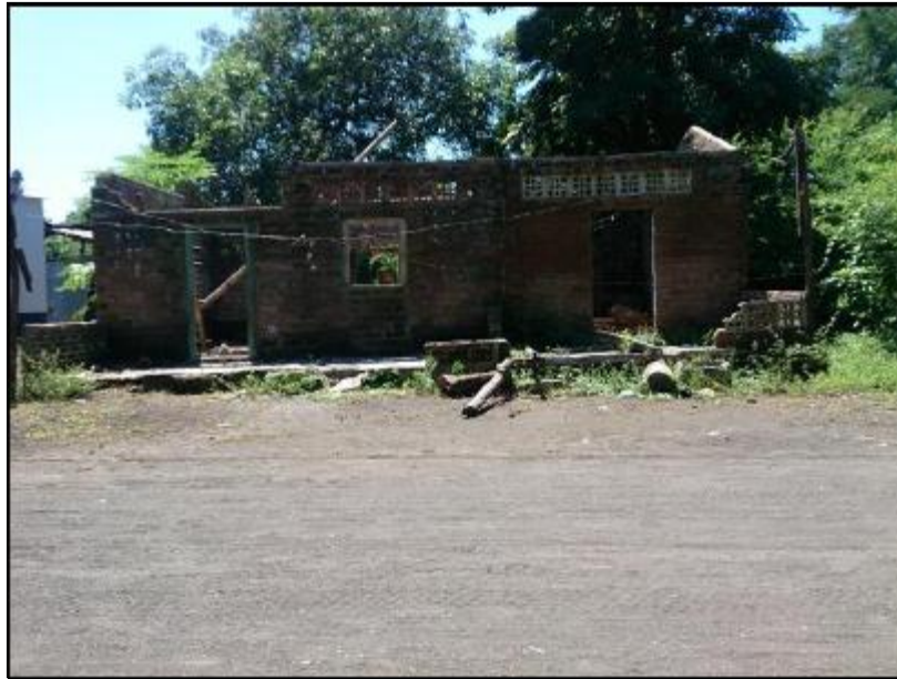
Foto 3. Vivienda la cual fue destruida por los enjambres sísmicos ocurridos en el año 2014.
