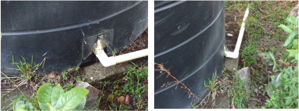
Figura 37. Deficiencia de operación y mantenimiento en tanque de almacenamiento.
