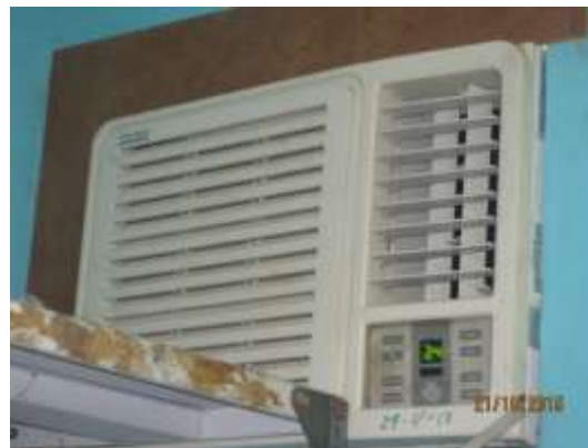
Ilustración 18: Aire acondicionado de Bodega de Insumos Médicos
