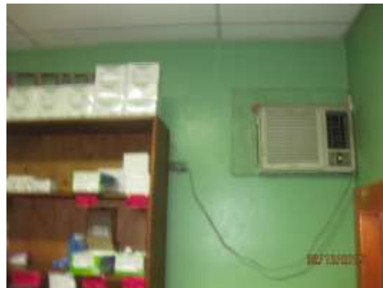
Ilustración 10: Aire acondicionado del área de Farmacia
