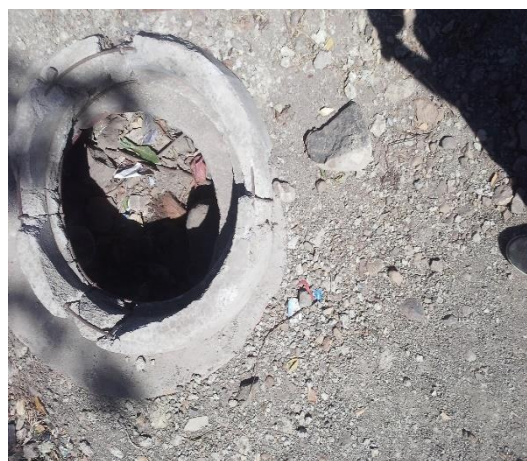
PVS 316 en mal estado
