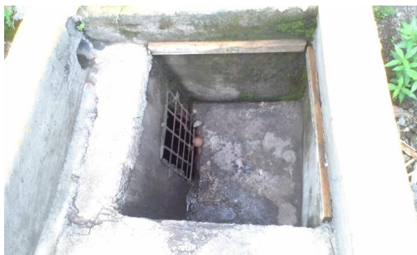
CR 9 además funciona como tragante
