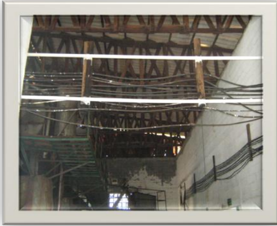
Foto 1.2.6.a. Cables colgantes en las áreas de protección de procesamiento
