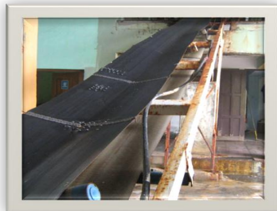
Foto 2.1.b. Estructura de la polea oxidada.
