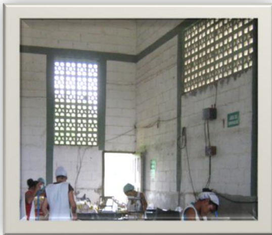
Foto.1.2.7.a. Ventanas no provistas de mallas de mallas
