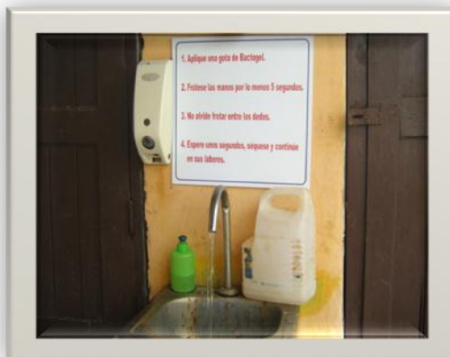
Foto 1.4.3. a. Lavamanos con como abastecimiento quede agua potable.
