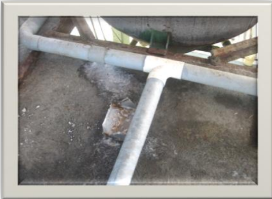
Foto. 1.3.2. a. Tubería no pintada No pasan sobre las líneas de procesamiento
