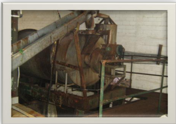
Foto 2.1.a. Equipos oxidados. oxidada.
