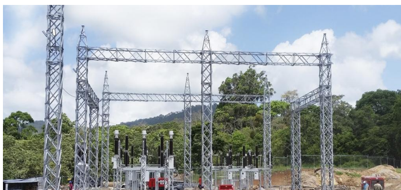
Subestación eléctrica, Municipio Tuma- la Dalia
