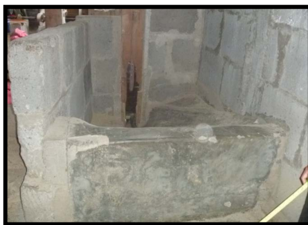
Pila de recepción para la granza
