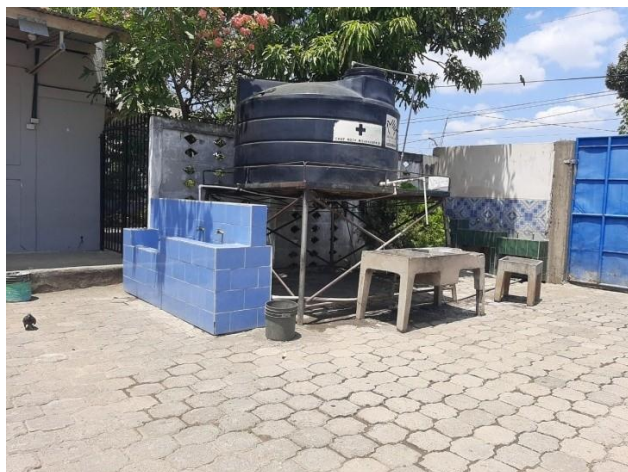
Figura 9: Tanque de almacenamiento de agua, lavamanos y lavadero.
