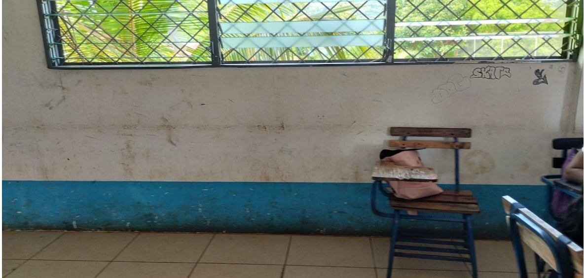
Paredes y persianas en estado regular
