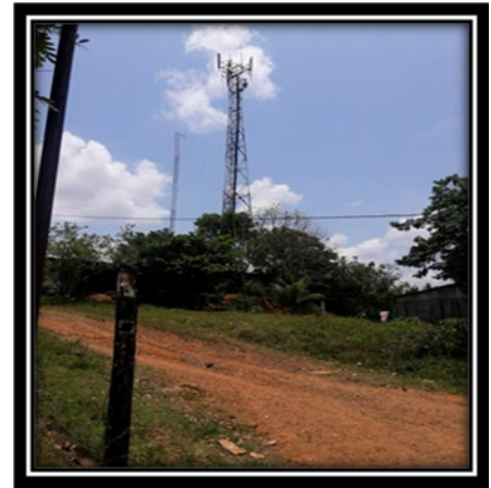
Ilustración 12; Antena de Telefonía,; Fuente; TELCOR
